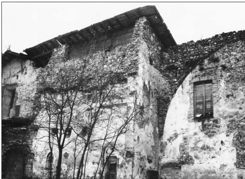
La parete del lato est (esistente): si notano i segni delle grandi volte ad archi acuti ribassati e la fascia frontale con l'affresco dell'Annunciazione
